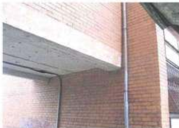
F-8. Ailu sijas virs caurbrauktuves. Redzami arī atklāti kabeļi ar metāla aizsargu. Šajā sekciju savienojuma vietā ārējā ūdens novadīšana, skārda notekas. Plaisas un tukšumi šuvēs starp pārseguma paneļiem un to pieslēgumos sijām.
