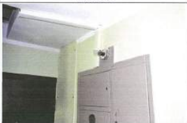
16.att Kāpņu telpas apgaismojums
